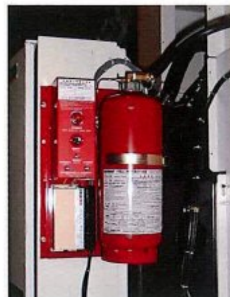
自動消火装置
